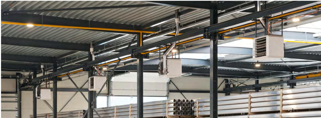
Beheizung Produktionshalle mit Lagerbereichen
